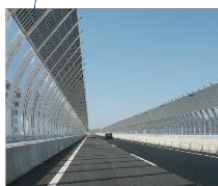
遮音壁(専用部)
