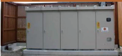
非常用電源装置
