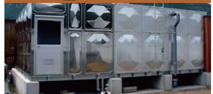
飲料水貯水槽
