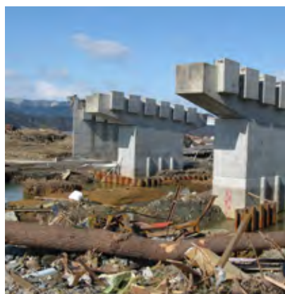
被災状況(3月18日)
