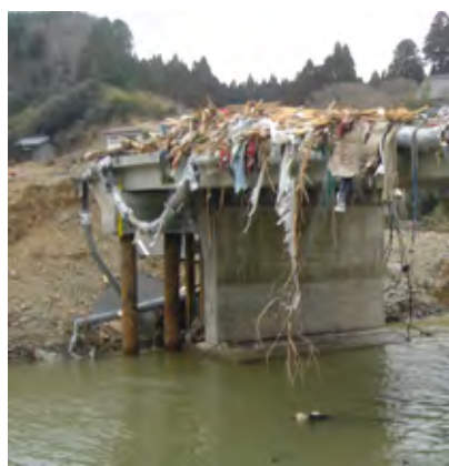
被災状況(3月15日)
