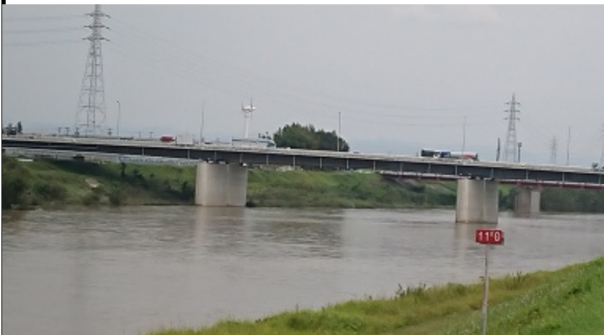
左岸11KM地点 台風の翌日の 志貴野橋。
