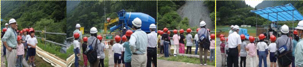
釜沢地区で施工中の砂防工事現場を見学。 私たちの生活を守るために山奥でがんばっているおじさん達にお礼をいいました
