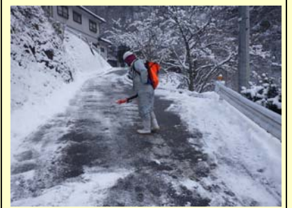
冬場は工事用道路の除雪・凍結融解材の散布は欠かせません。
