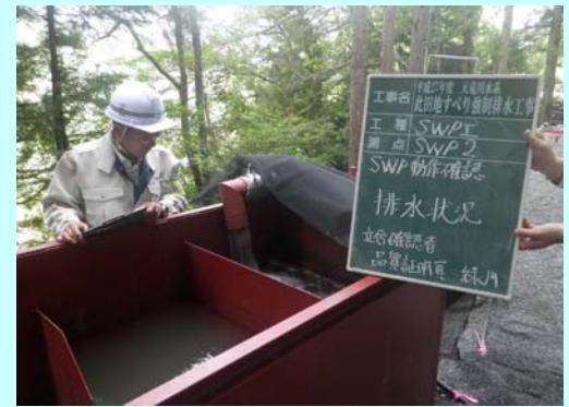
強制排水状況(動作試験)
