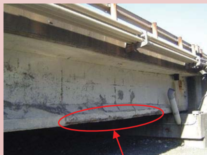
旧橋の損傷状況：コンクリートの剥離
