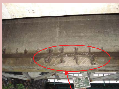
旧橋の損傷状況：鉄筋の露出
