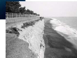
清水海岸の被災状況(H4)
