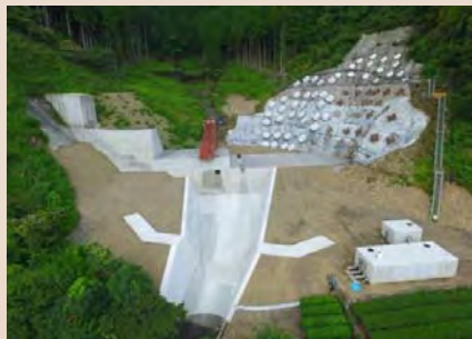
H25年度から施工中の杉の木沢砂防堰堤 (H29年9月末状況)
