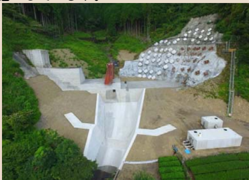
H25年度から施工中の杉の木沢砂防堰堤 (H29年9月末状況)
