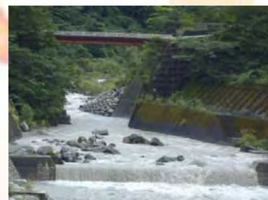
21日8:20 大ザレ護岸の状況
