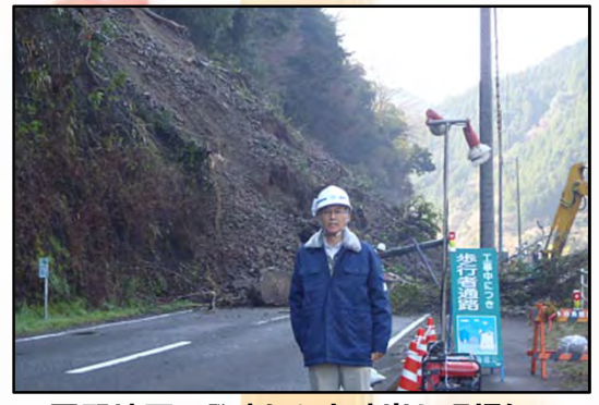
平野地区で発生した土砂崩れ現場にて
