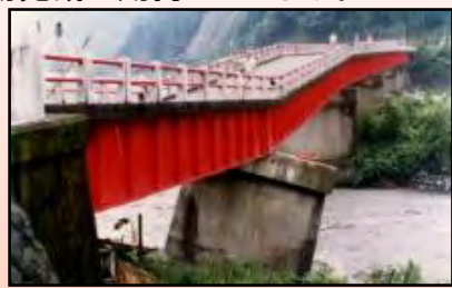
大河内橋の被災写真(S58年)
