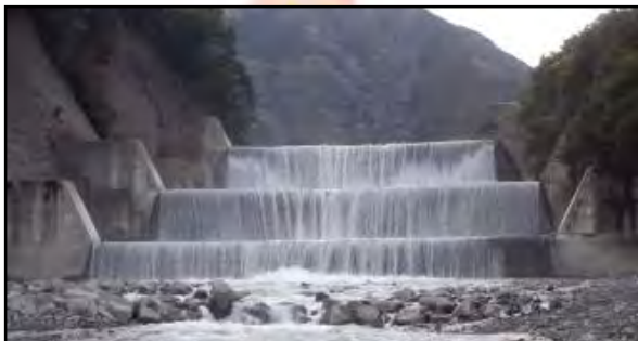
半世紀以上経過し水通し部が摩耗した大河内堰堤
