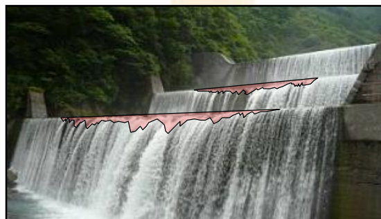
金山砂防堰堤の天端摩耗状況(赤色部分)
