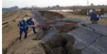
TEC-FORCEによる堤防被災状況調査 (東北地方整備局資料)
