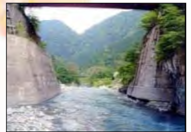
コンヤ橋の橋台下部洗掘状況
