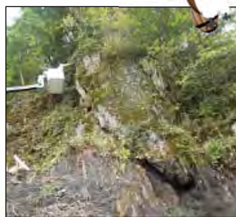
崩落が懸念された露出岩(作業現場より上方を望む)
