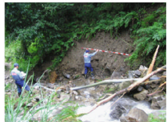
渓流部の崩落状況を調査中 (岐阜県揖斐郡池田町藤代地内)
