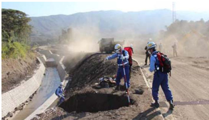
溪流保全工背後の洗掘状況を調査
