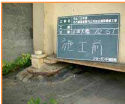
【補修前（支承の腐食）】
