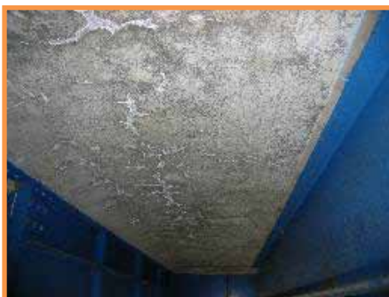
【補修前（床版コンクリートひびわれ）】
