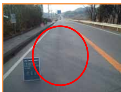
【ひび割れ状況】
