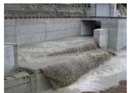
③三峰川バイパストンネル呑口 (横越流堤での流量調節の状況)
