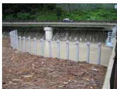
②三峰川バイパス水路流入部 (流木止が流木を止めている状況)
