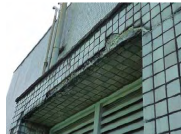
劣化した外壁の状況
