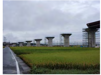
国道 23 号名豊道路(豊橋バイパス) 小坂井高架橋(仮称)の状況
