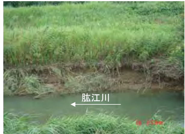
欠壊箇所拡大写真
