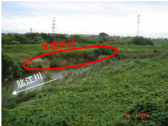
肱江川右岸決壊箇所
