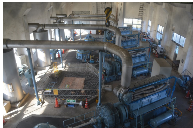
建屋内のポンプ機械設備
