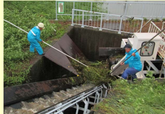
排水機場に流れ着いた草を取り除く 操作員の方々（平成25年9月撮影）
