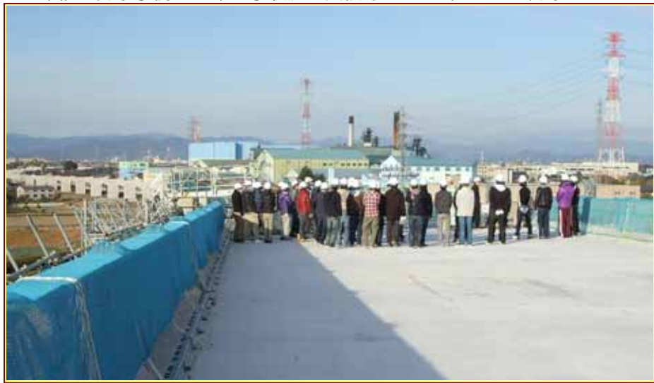
東海環状自動車道(西部区間)大垣市綾野地区 工事中の高架橋上から見学する技術系の大学生(平成22年11月16日、約40名参加)
