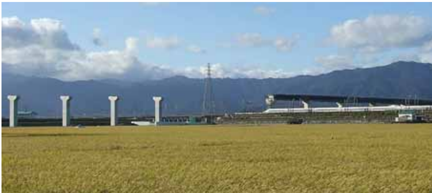
工事が進む東海環状自動車道 西部区間;大垣地区(平成22年10月撮影) (東海道新幹線北側(写真右)は高架橋の架設中、南側(写真左)は橋脚が完成)
