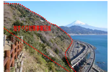
【地すべり対策事業箇所】
