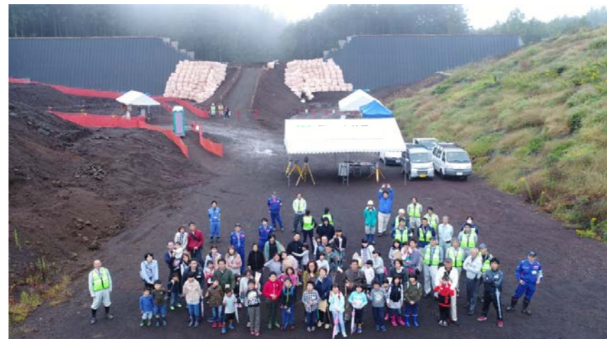
施工中の鞍骨沢遊砂地をバックにUAVを使って記念撮影
