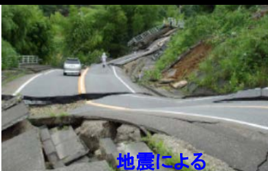
特異な被災状況調査
