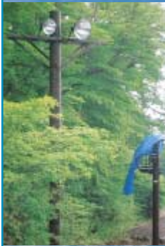
●照明ポール 左：ナトリウムランプ 右：ハロゲンランプ
