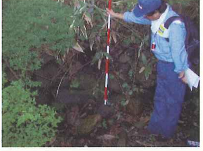
石積みの崩落状況
