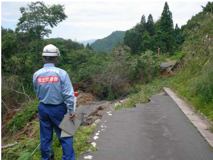
市道崩落状況
