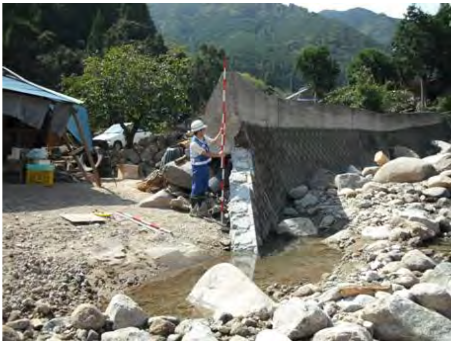
被災状況調査 (三重県熊野市、紀宝町、御浜町)
